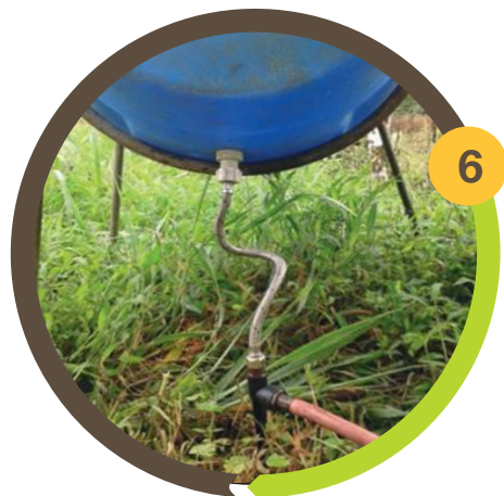
Figura 6: Sistema de abasto instalado.
